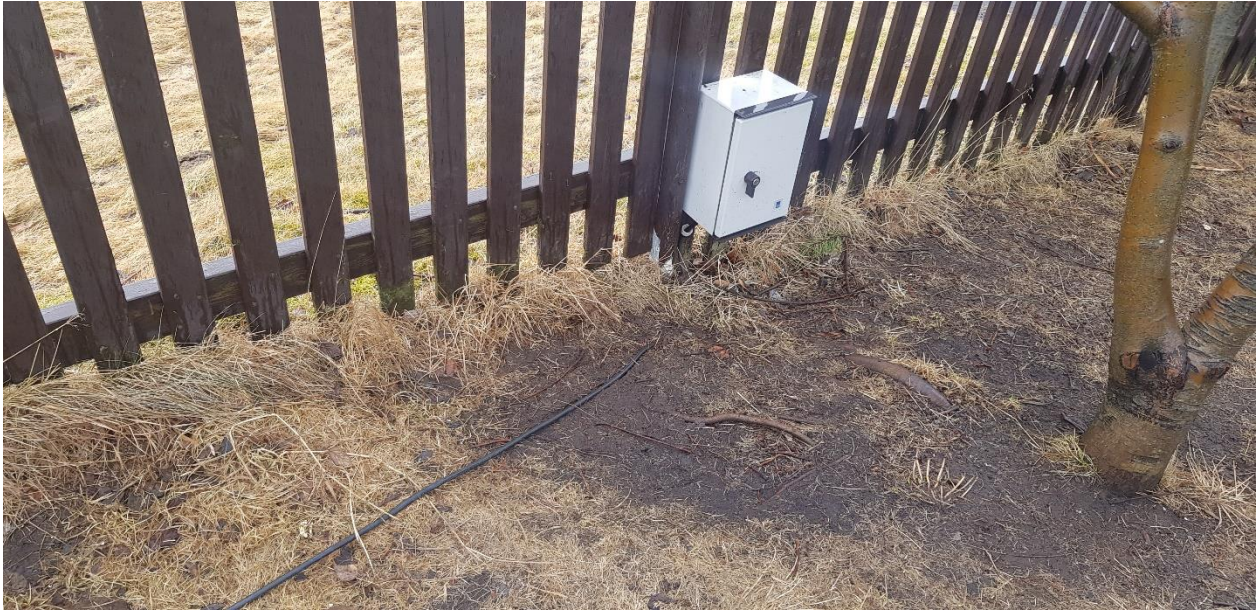
Rafmagnssnúra á yfirborði . þarf að skoða.
